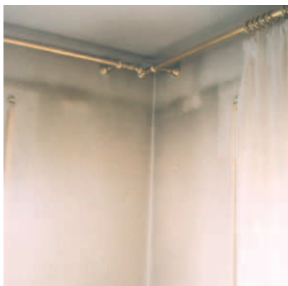
Die schwarzen Beläge traten in diesem Zimmer 6 Monate nach der Renovierung auf.
